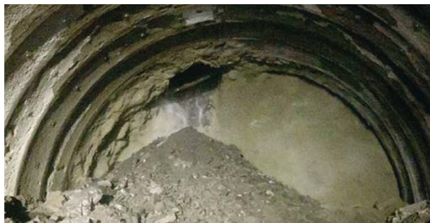
多量湧水・天端崩落の状況
