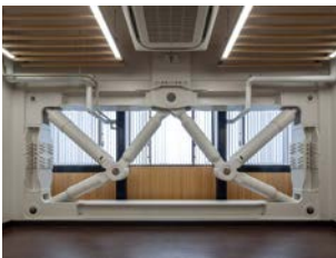
制振ブレース
